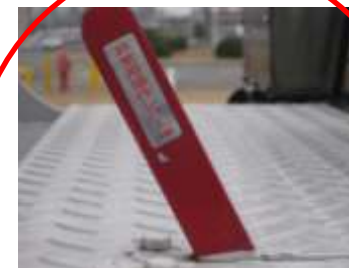
緊急遮断弁操作レバー
